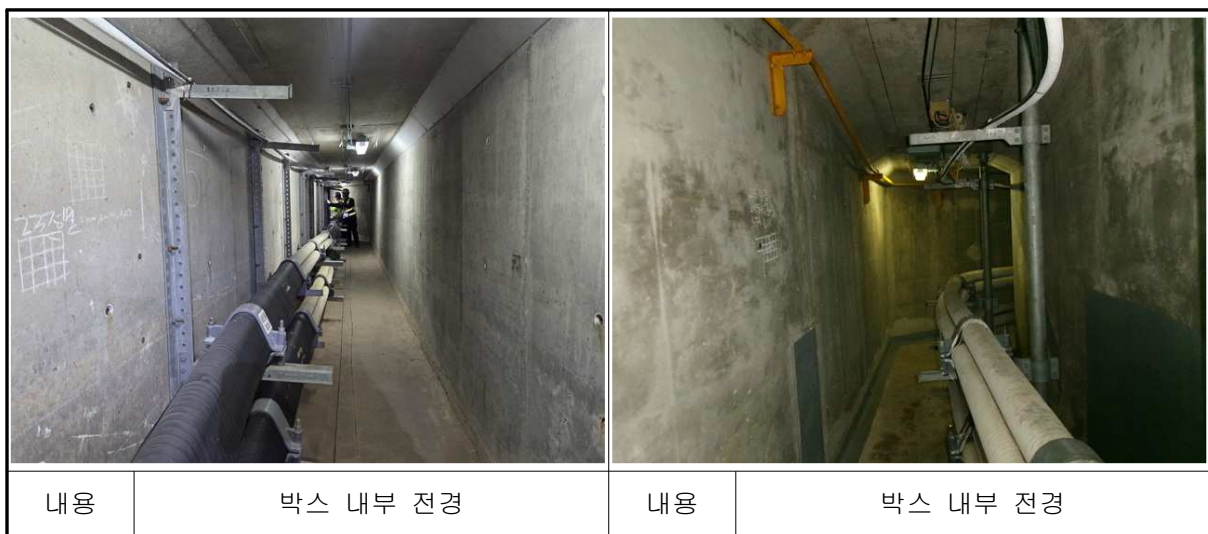
【사진 4.1】 송포일산인출 전력구 현황
